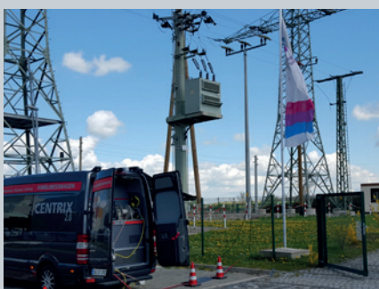
Pomiary i diagnostyka kabli
