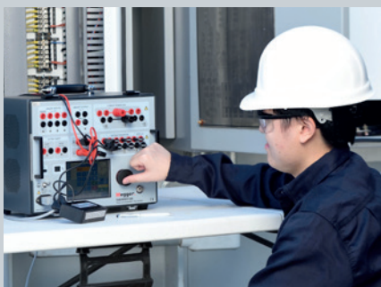
Testowanie automatyki zabezpieczeniowej
